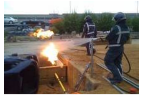
VU Pkw in Baugrube, Gasleitung beschädigt
